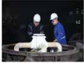
Şekil 5a: Filtre kutusu ve alt derce- de çalışan sistem kurulumu
