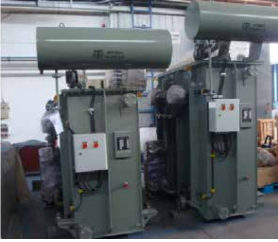
▲ Şekil 4: Radyatörsüz su soğutmalı trafolar
